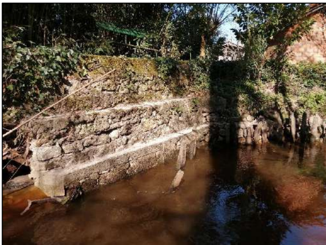
Photo 13 : Protection de berge en pierres maçonnées et pieux bois en rive droite
