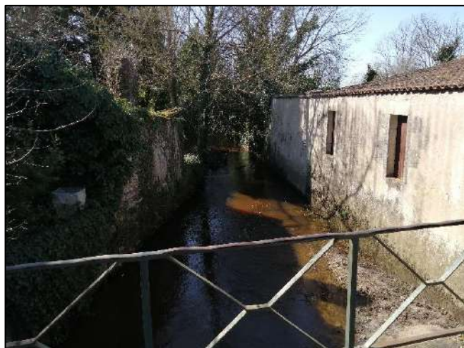
Photo 7 : Murs vers l'aval du Pont Gambetta
