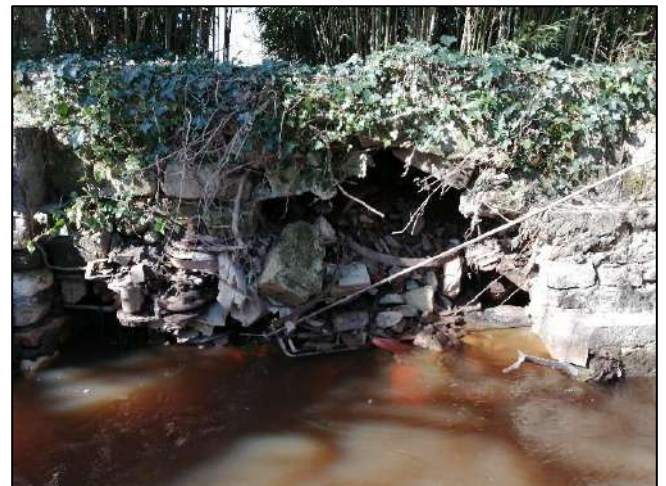
Photo 14 : Déstabilisation de la protection de berge
