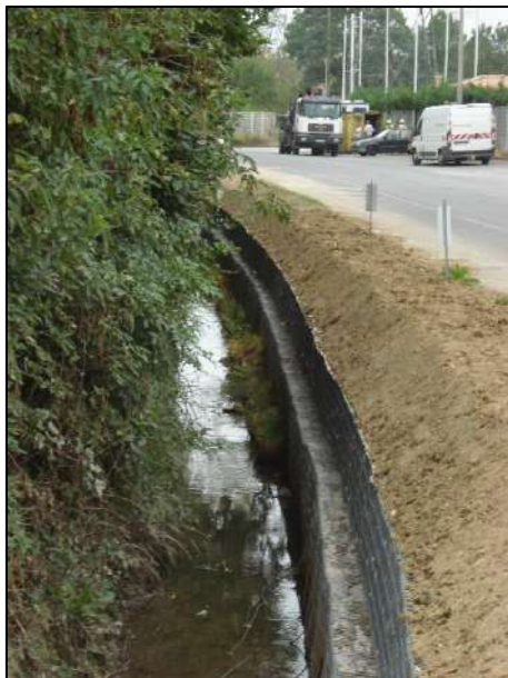
Photo 22 : Exemple de protection de berge en gabion avec boudins d'hélophytes en pied
